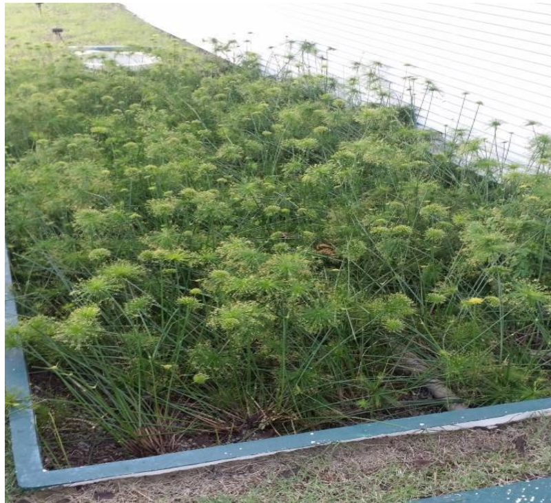
Figura 2: Tratamento aeróbio pela wetland vertical na edificação comercial Fonte: Núcleo de Bioengenharia Aplicada ao Saneamento UFES
