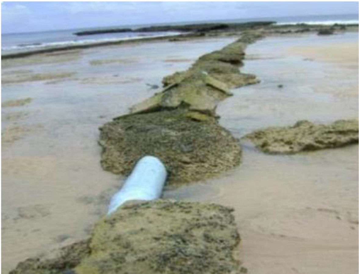
Figura 17: Adutora de PVC do sistema de captação da água do mar na praia de Boldró, em Fernando de Noronha.
